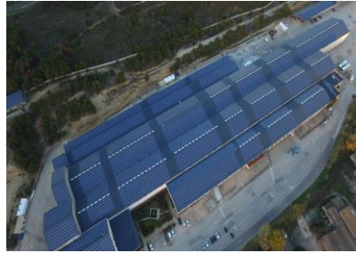
Centrale en toiture Bouches du Rhône
