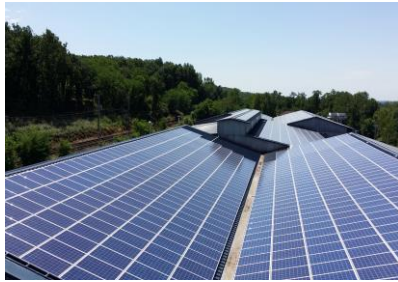
Centrale en toiture Tarn et Garonne
